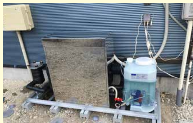
リラクア-Kを設置しました！ 標高が高いところなので配管もしっかり保護してあります(^o^)
